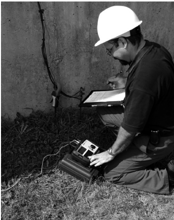
Verwendung der ART -Methode mit einem Megger DET3-Gerät zur Prüfung kommerzieller Erdungen ohne Trennen des Systems
