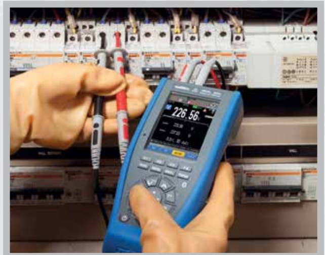
Messungen an elektrischen Schaltschränken
